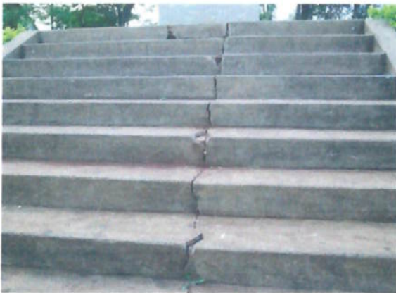
Escada com trincas
